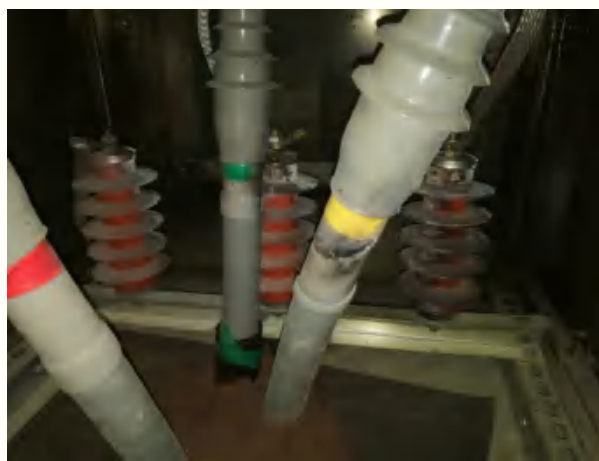
图1 环网柜凝露故障
