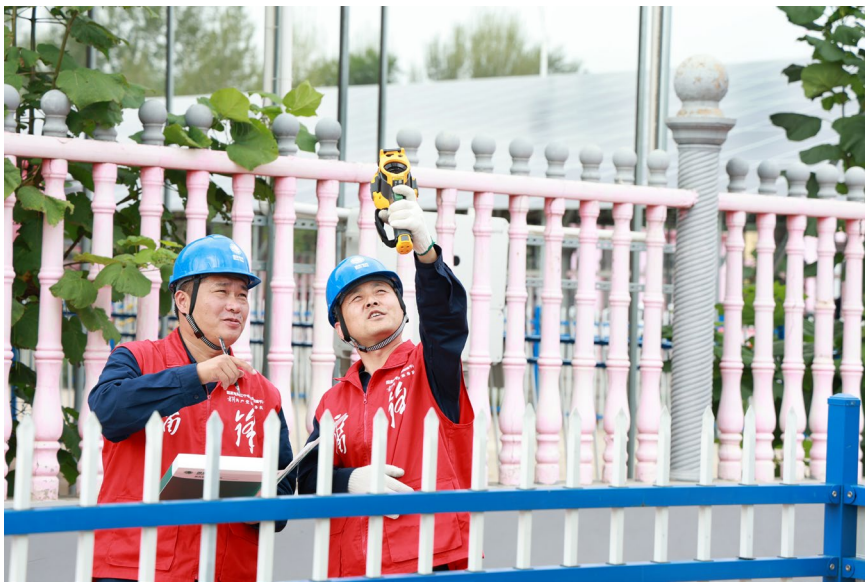
国网辽宁电力(朝阳)雷锋共产党员服务队到企业为光伏设备设施进行接点测温
