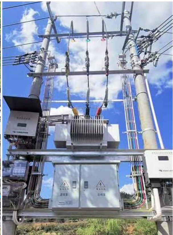
配电变压器、补偿、柔性直流综合调压装置/李 泵 摄
