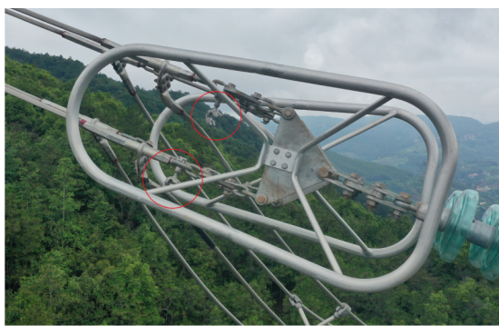
图13 调距间隔棒松脱照片
