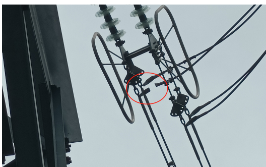
图1 耐张线夹断裂情况
