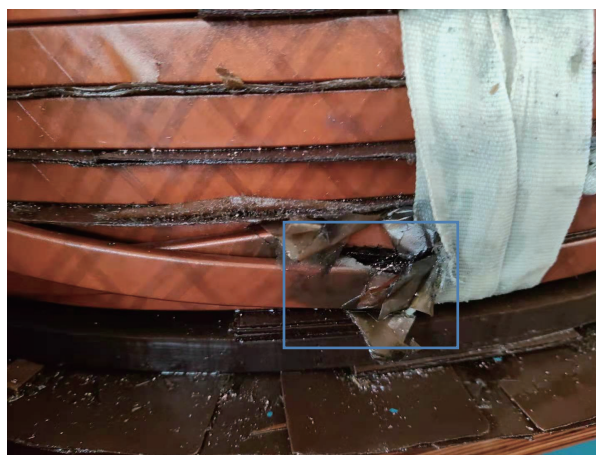
图1 故障变压器解体检查高压侧 A 相绕组情况
