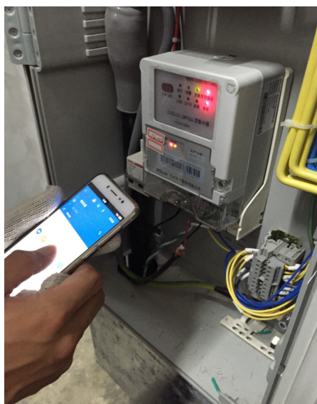
图3 采集终端安装点信号测试
