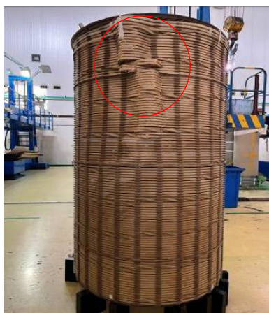
图 6 A 相中压绕组变形情况
