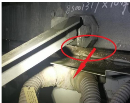
图2 开关机构箱与外侧防雨板连接处渗漏水
