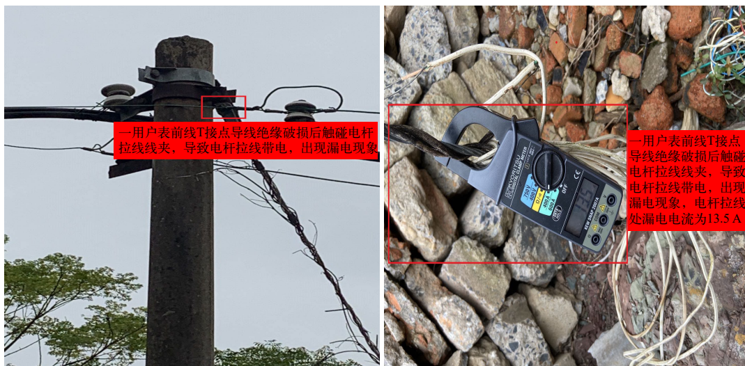
图 1 某拉线上现场测得漏电电流 13.5 A
