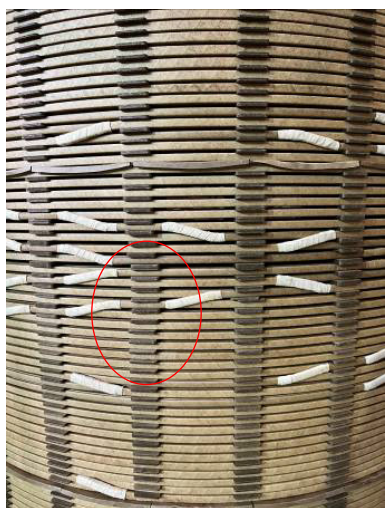
图 5 高压绕组垫块偏移情况
