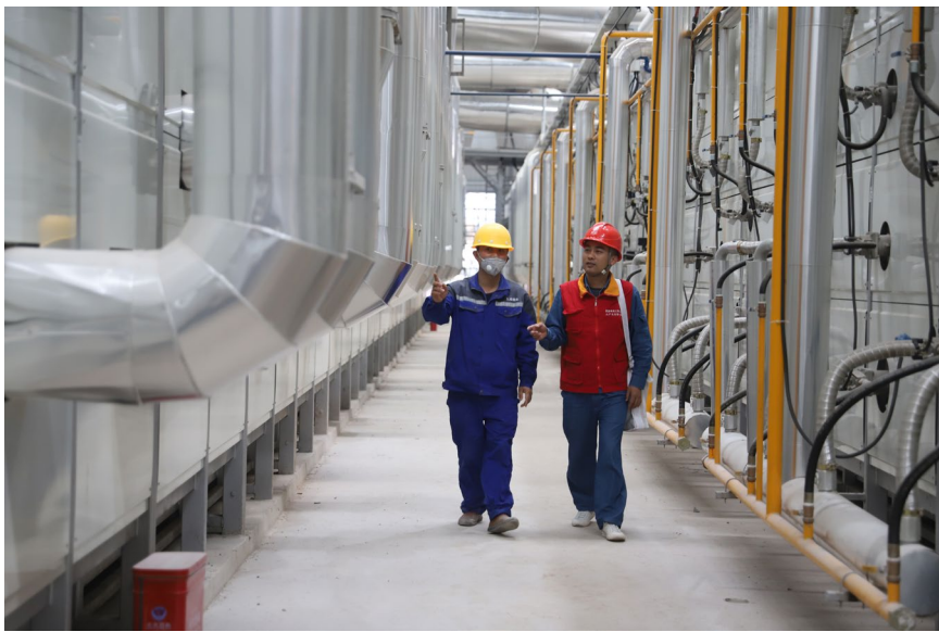
镜山工业园供电所党员在江西天成锂业有限公司巡视检查生产车间用电设备
