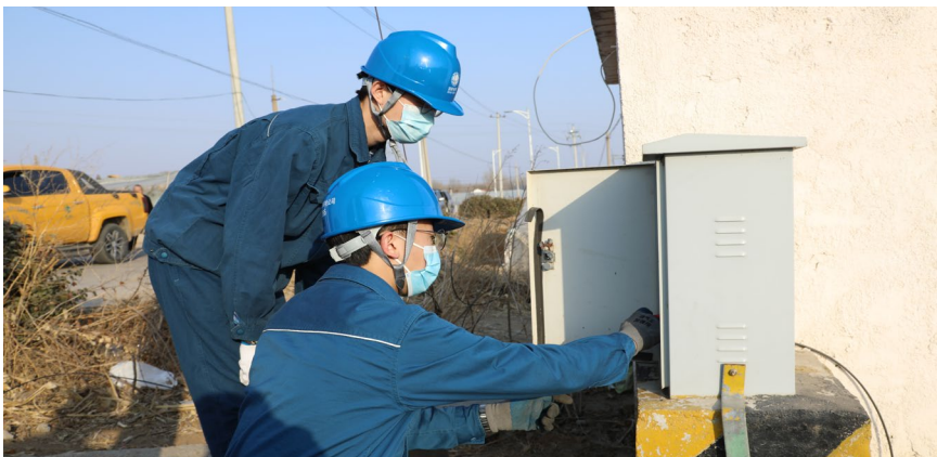
员工在田间地头检查配电箱
