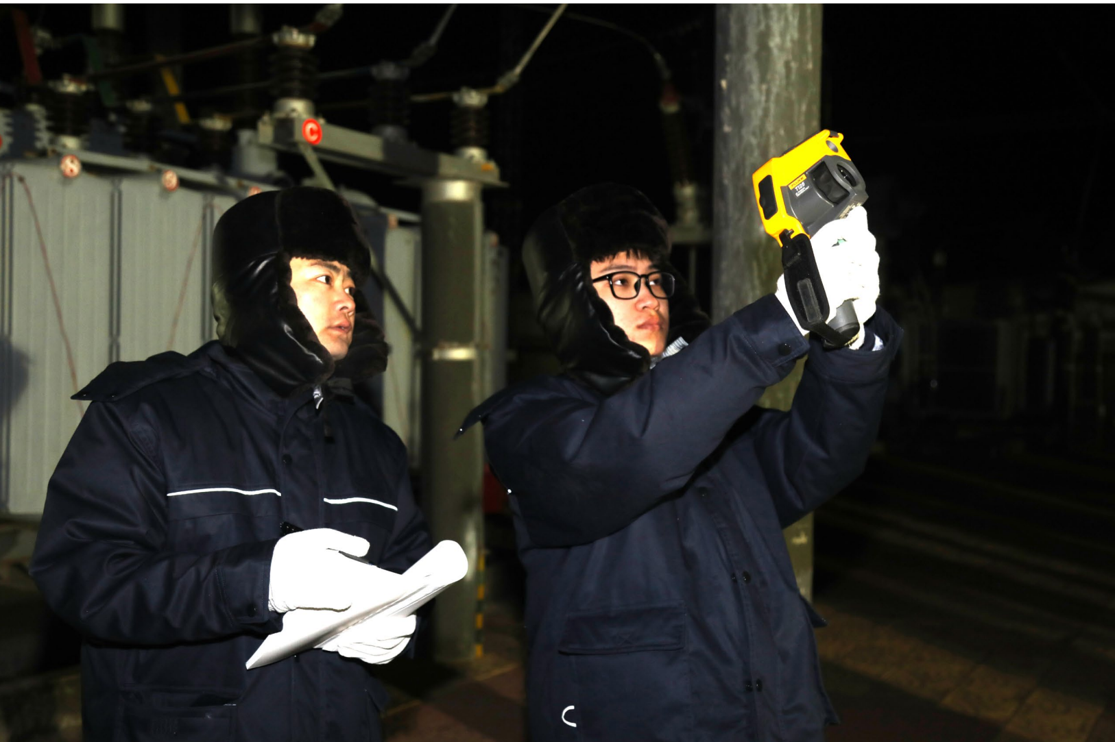
2021年12月31日凌晨，蒙东赤峰敖汉旗供电公司运维检修人员正在对66 kV镇北变电站进行元旦保供电夜巡/张振远 摄
