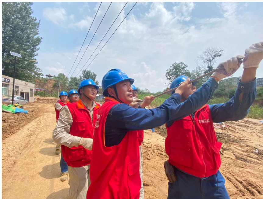
公司接豫抢险队在郑州市二七区樱桃沟10 kV王庙嘴线进行倒杆抢修
