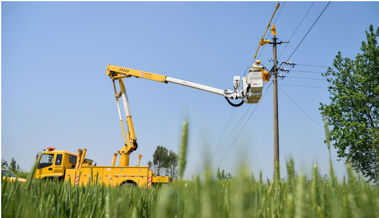
及时处置农业排灌电力设施的隐患和故障，全力确保农民灌溉用电
