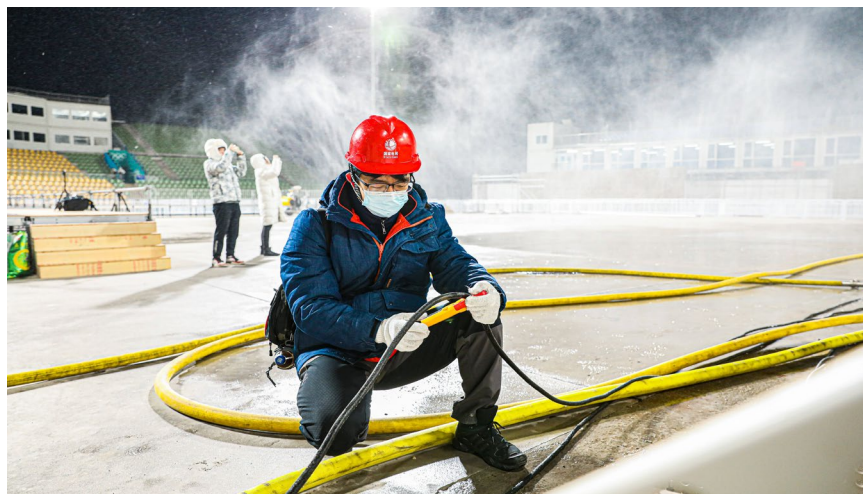
国网北京石景山供电公司首钢滑雪大跳台电力保障团队队员采集造雪设备电气量参数
