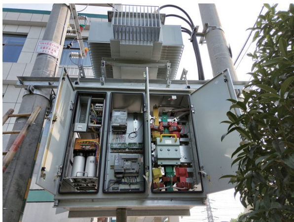
图3 低压综合配电箱
