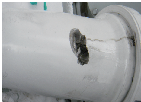
图4 插座部分外壁放电痕迹的近景图像
