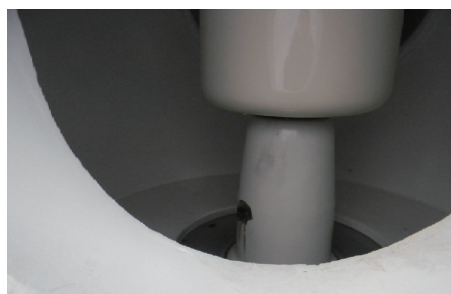
图3 插座部分外壁带电运行时处于1#主变的电缆仓中
