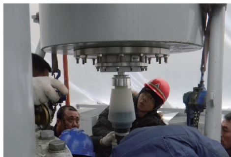
图1 故障高压电缆终端解体检查
