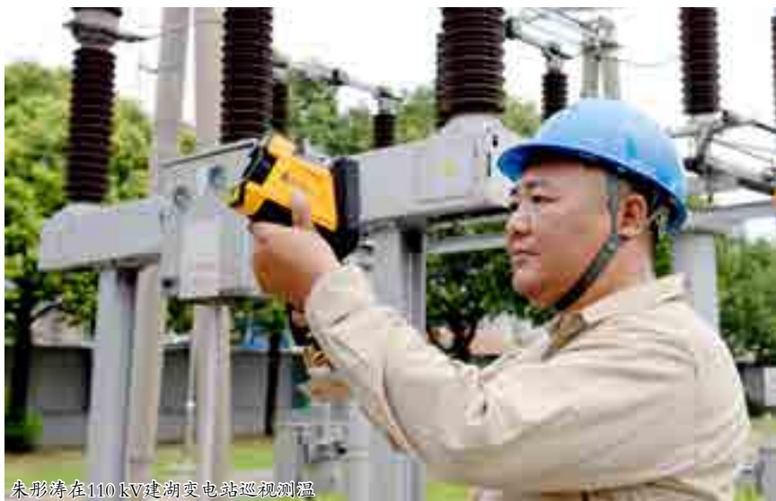
朱彤涛在110 kV建湖变电站巡视测温
