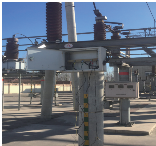
图3 避雷器全电流和阻性电流测试接线箱
