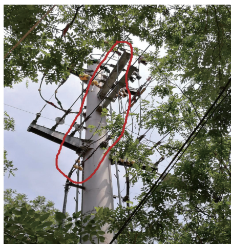
图2 现场跌落式熔断器及引线状况(正面)
