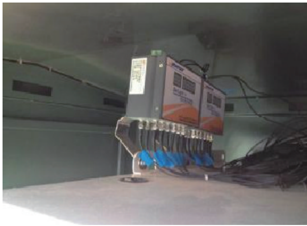
图7 检测模块现场安装
