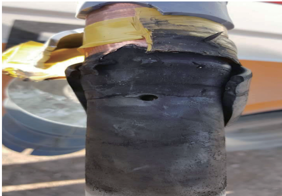
图2 2号主变高压侧C相电缆解剖情况
