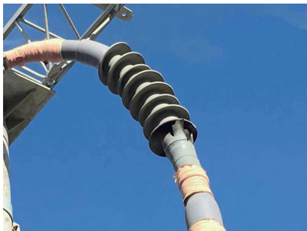
图 1 高压侧 C 相电缆头故障情况
