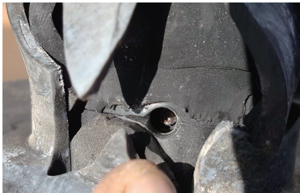
图3 2号主变高压侧C相电缆解剖发现故障情况
