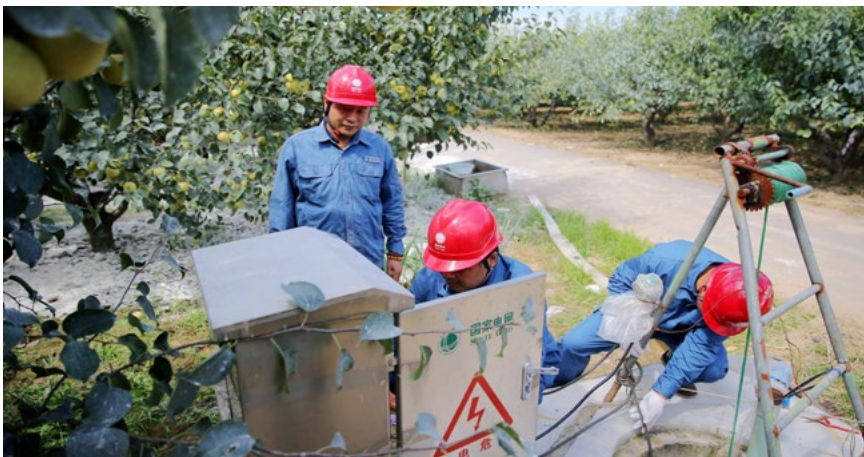
供电员工检查机井通电情况
