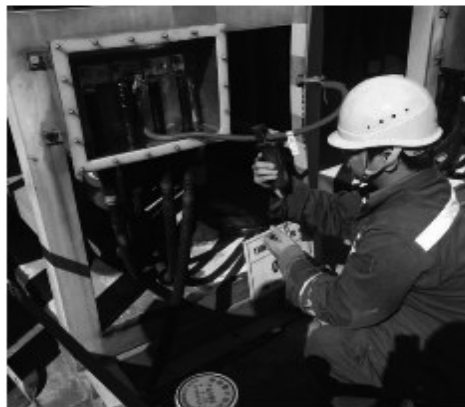
图5 测量临时接地线的接地电流
