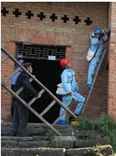
供电员工上门为贫困户检查线路
