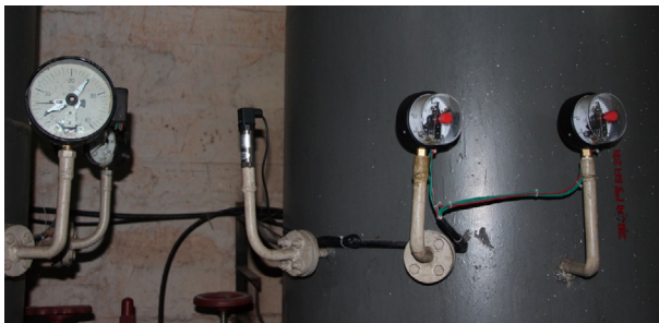
图3 压缩空气系统低压气罐的压力监视 具体需要满足内容如表 1 所示。
