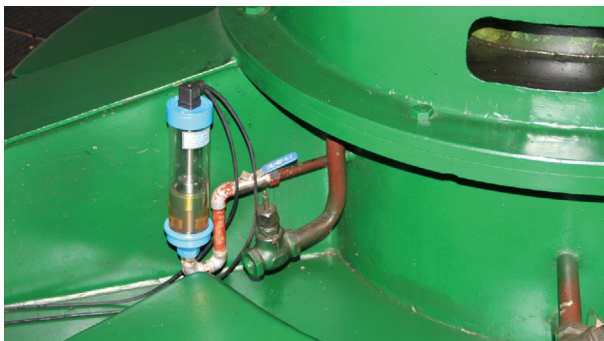
图2 推力轴承油位监控
