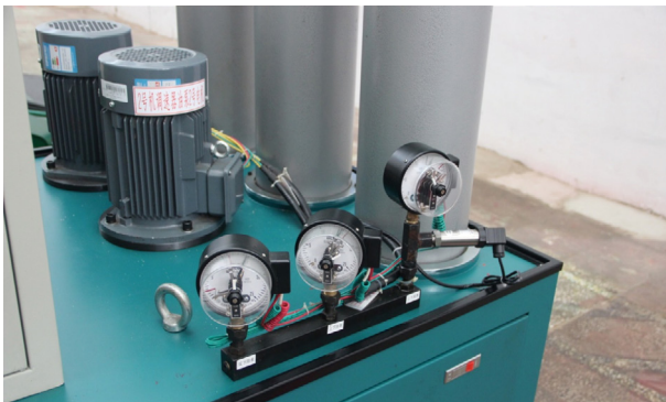
图1 调速器油压监控
