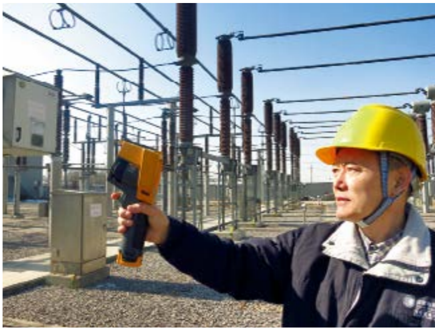
郭勇在进行变电站维护
