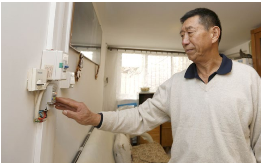
西四北二条胡同的武丕显正在检查电采暖开关/程伟 摄
