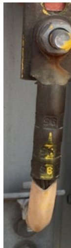
图2 接地扁铁穿过穿心传感器部分改造图
