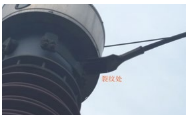
图2 某运行中电流互感器的设备线夹出线裂纹
